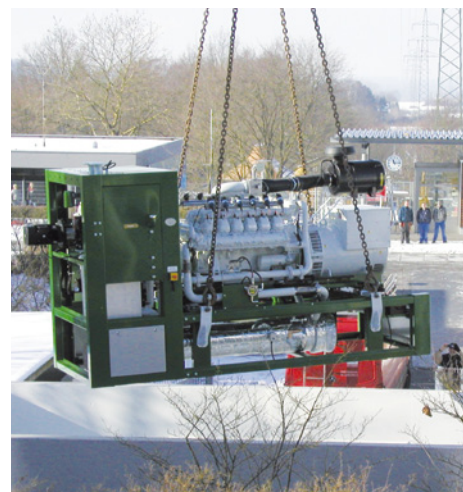
Contractoren setzen heute meist wie hier auf die besonders effizienten Blockheizkraftwerke.
