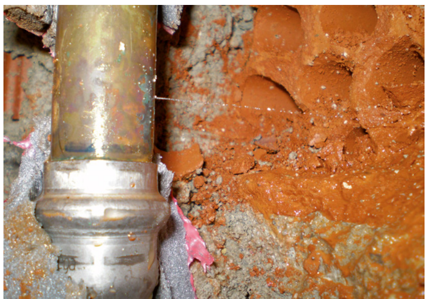
Lochkorrosion an einer Cu-Leitung
