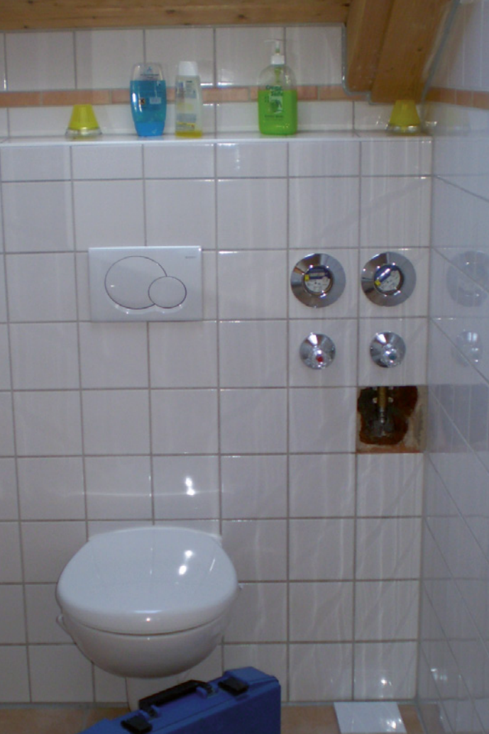
Freigelegte Leckstelle ohne größere Zerstörung der Bausubstanz
